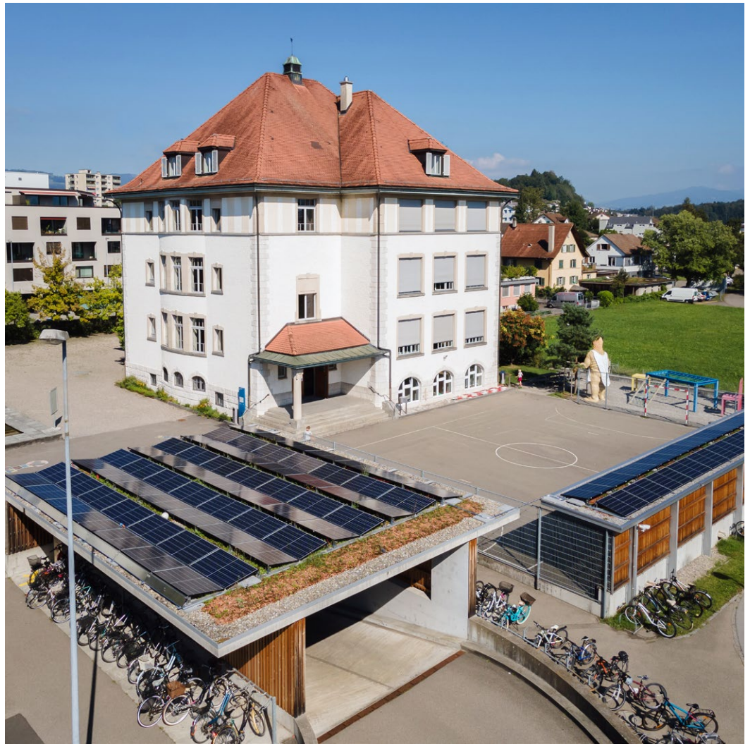
Das Schulhaus Dorf im Zentrum von Jona wird mit sauberer Energie versorgt.
